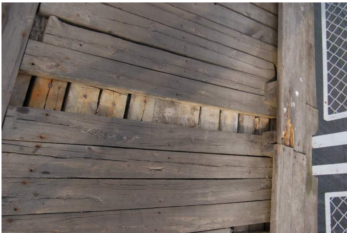
Fot.3. Ubytki w nawierzchni jezdni
